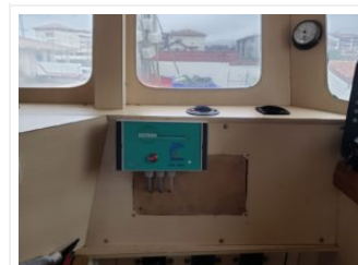
Dispositif installé dans la cabine © PDA
